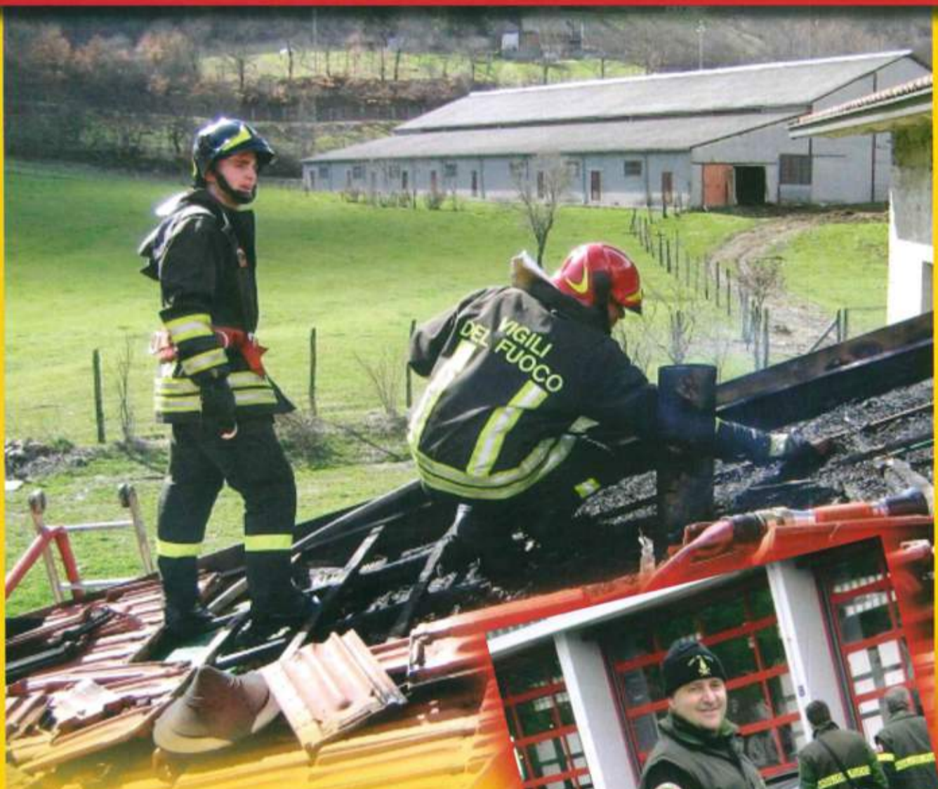
Particolare dei danni provocati da un incendio sviluppatosi nell'intercapedine del tetto
