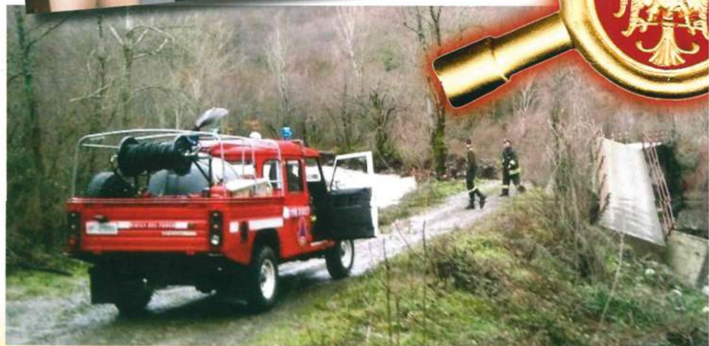
Sopraluogo e verifica del cedimento di un ponte a Boschetto di Albareto dopo un'alluvione.
